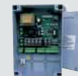
Armoire de commande
